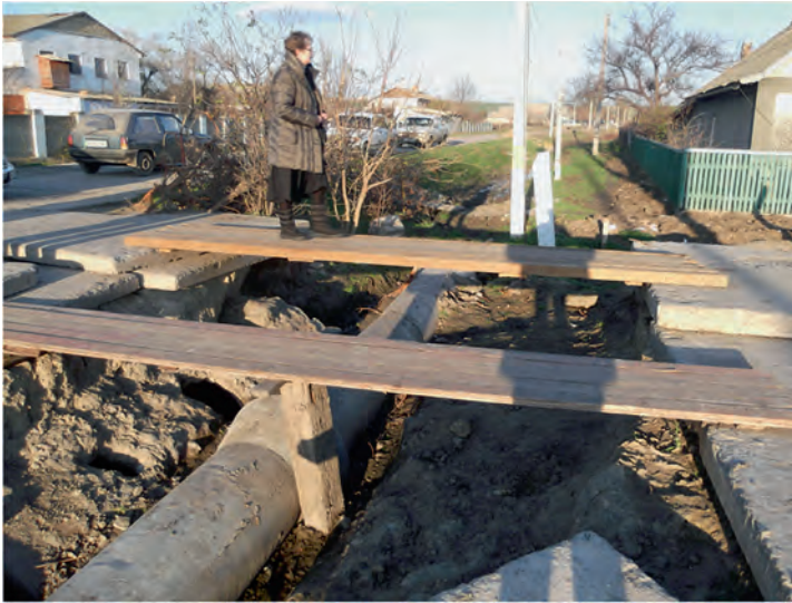
Zerstörte Brücke im Dorf.
