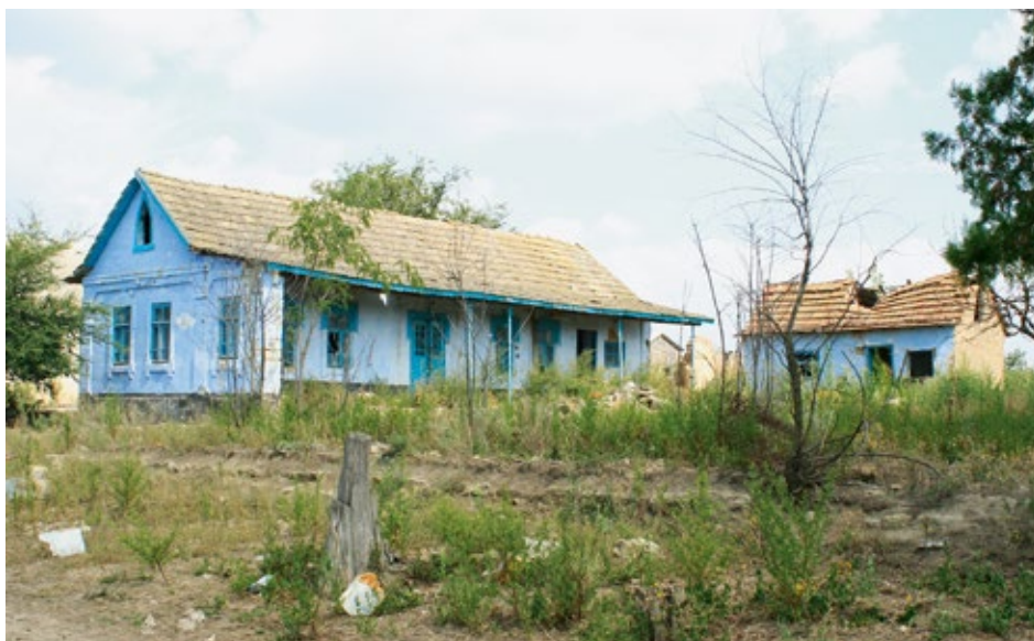
Heutzutage sieht man in Katzbach/Luzhanka sehr viele im Verfall begriffene Hofstellen
