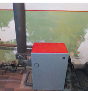
Die neue Gasheizung im Kulturhaus Peterstal
