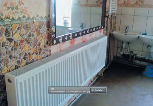
Neue Heizkörper im Kindergarten Sofiewka
