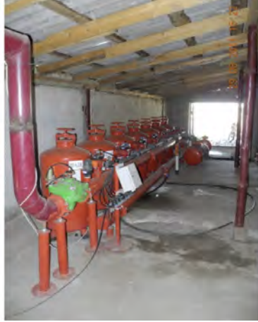
Pumpstation der „Tröpfchen-Bewässerungsanlage“.
