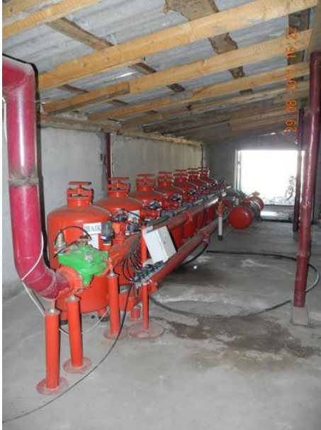
Pumpstation der „Tröpfchen-Bewässerungsanlage“
